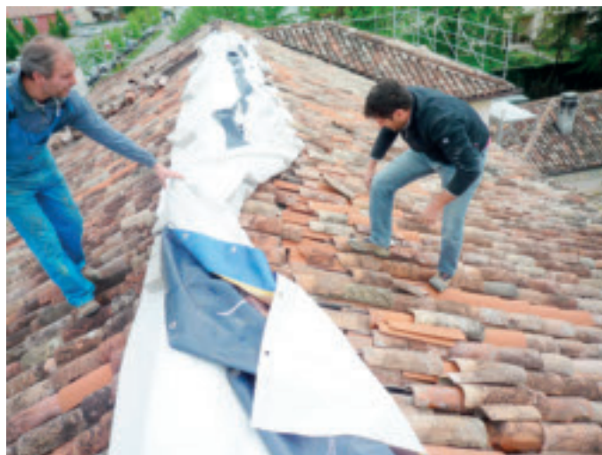
Così era il tetto devastato dal temporale e dallo scorrimento delle tegole. Ora è stato curato l'isolamento e tutte le tegole sono fissate da ganci.
