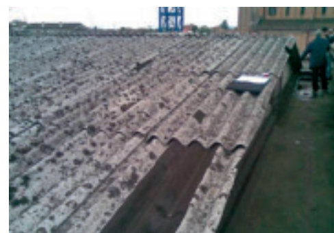
Particolare del tetto in eternit
