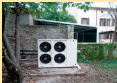
Pompa di calore della canonica
