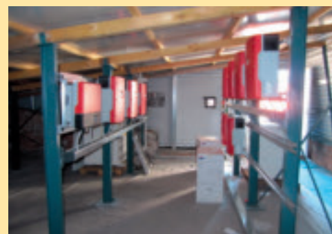
Inverters e trasformatori sistemati nel nuovo sottotetto del patronato
