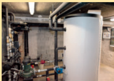
Serbatoio di acqua calda per il riscaldamento del patronato
